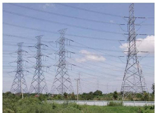
เสาไฟฟ้า
