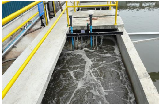
บ่อบำบัดน้ำเสีย
